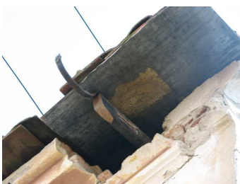
Loch am Gesims, verrotteter Sparren (Schornstein), verrottete Endstücke
