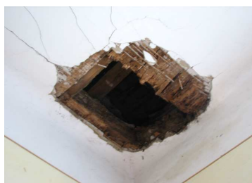
Loch am Dach, fehlende Holzbalkenköpfe
