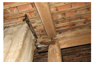
fehlendes Teilstück Dachpfette
