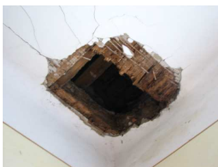
Gaură la tavan, capete de grindă de planșeu lipsă
