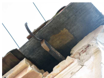
Gaură în cornișă, căprior putrezit
