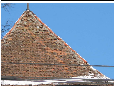
Schadhafte Firstziegel am Turm
