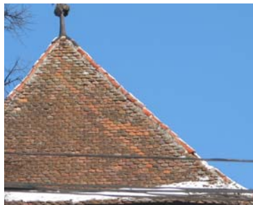
Țigle de coamă degradate la turn
