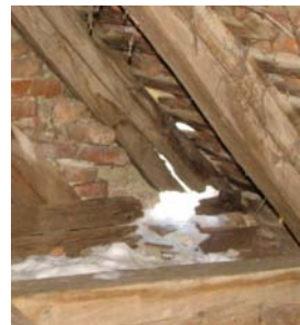
Capete de căprior și coardă putrede
