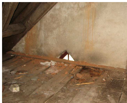
Verfaulte Elemente in der Westseite des Schiffes
