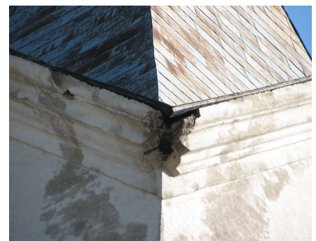
Geschädigtes Gesims durch eindringendes Wasser
