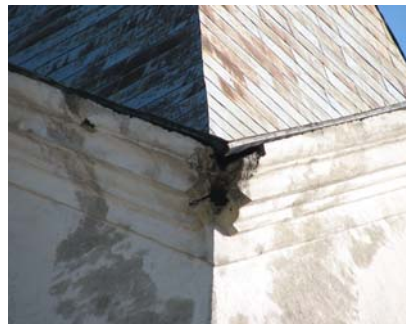
Cornișă degradată din cauza infiltrațiilor de apă
