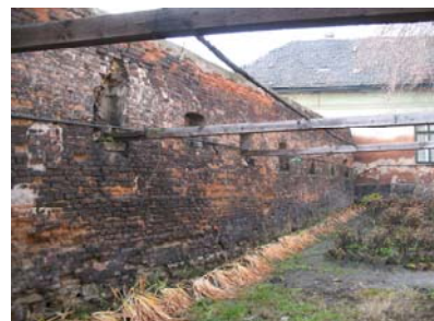
Zid de incintă cu degradări
