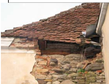
Eingestürzte Mauer an der W-Fassade
