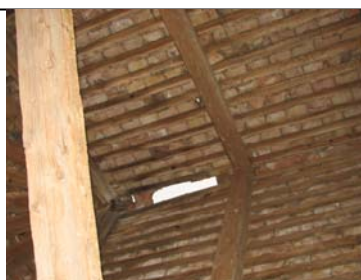
fehlende Firsten am Kirchenschiff
