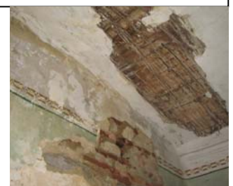
Schäden an der Decke
