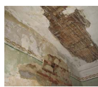
Degradări la planșeu
