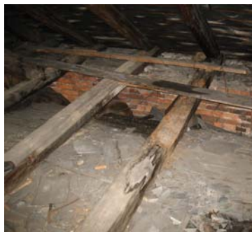
Elemente șarpantă putrezite
