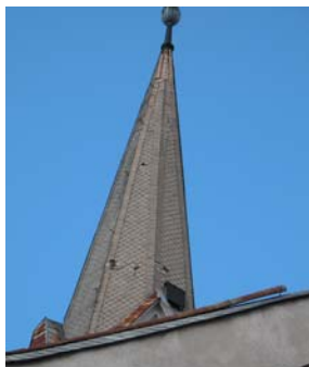
Degradări la turn și aticuri zidărie
