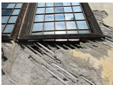
geschädigtes Fensterelement N-Fassade
