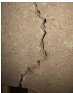
Crăpătură la arc între turn și navă
