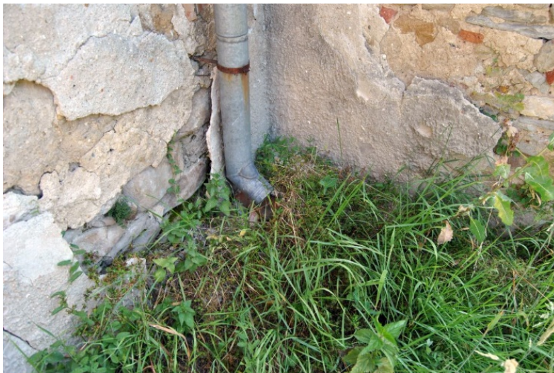
Abb. 28 – Fehlende Anschluss zum Ablauf des Regenwassers vom Sockel weg
