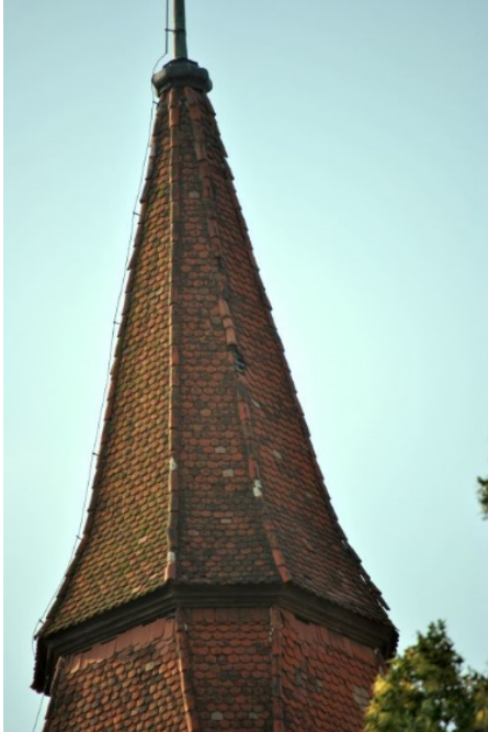
Abb. 41 – Turmhaube, beschädigter Grat
