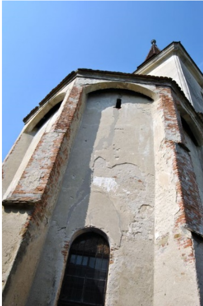
Abb. 23 – Chor, Nordost, verfüllter Riss
