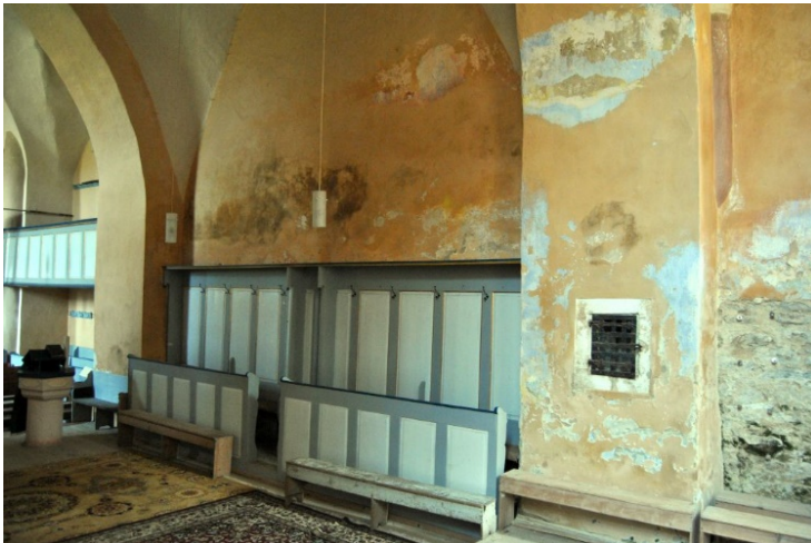
Abb. 14 – Chorturmquadrat – Nord – hohe Feuchtigkeit
