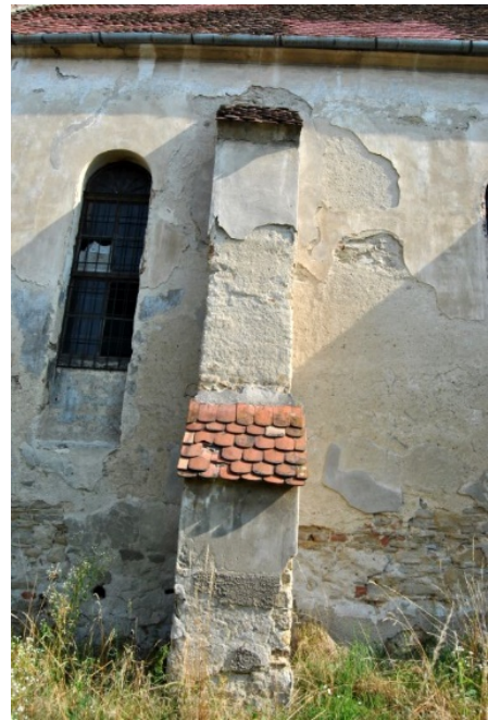
Abb.20 – Südfassade, Putzschäden, Pfeilerabdeckung defekt
