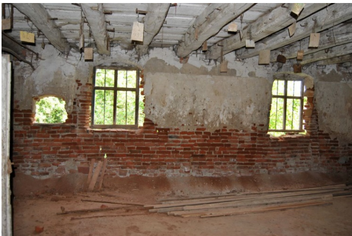
Abb. 47 – Kampfhaus, Schäden durch Salze (Speck, Bodenfeuchte, Klima)
