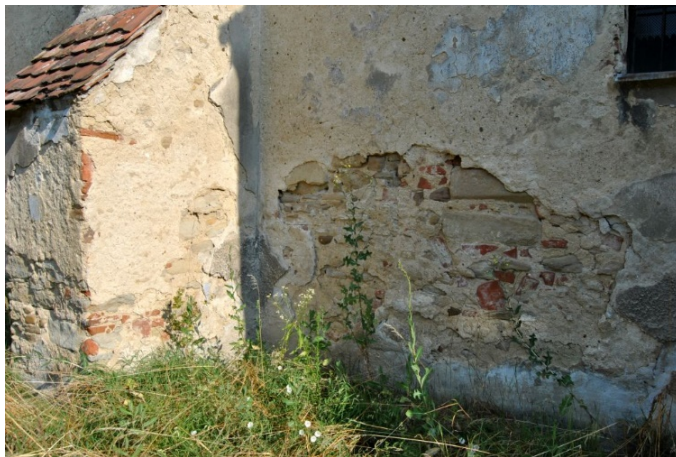
Abb. 21 – Südfassade, Putzschäden, Wildwuchs
