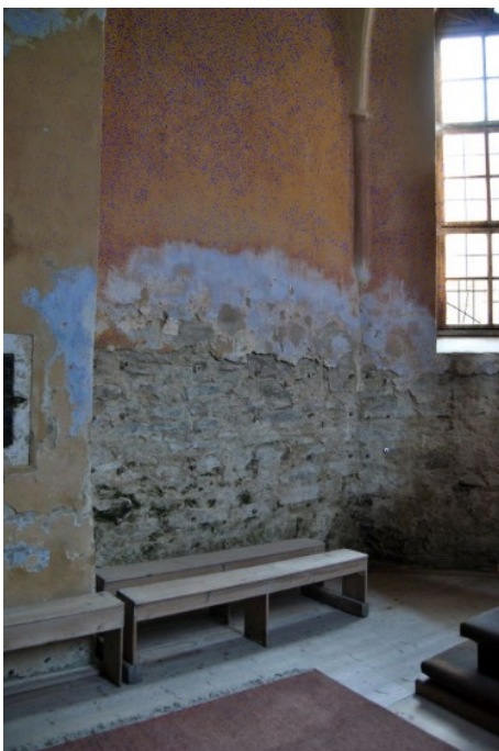
Abb. 15 – Chor, Nord, hohe Feuchtigkeit
