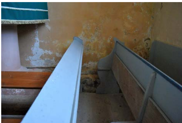
Abb. 11 – Langhaus, nahe Kanzel, Feuchtigkeitsschäden
