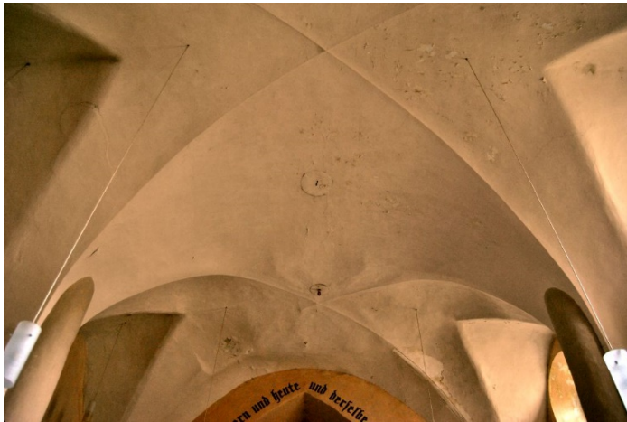
Abb. 08 – Langhaus, Gewölbe, Putz- und Farbschäden
