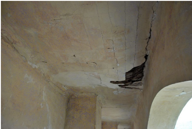
Abb. 31 – Nordempore, außen, Schäden an der Decke
