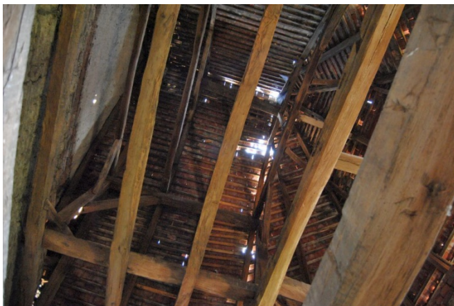
Abb. 36 – Dach, Chor, innen, defekte Deckung
