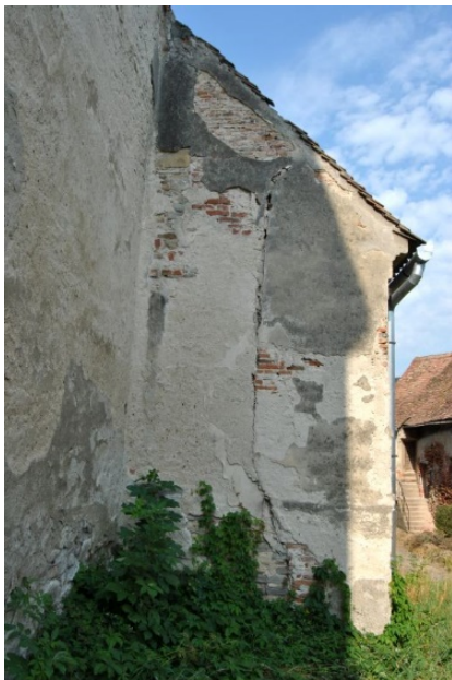
Abb. 25 – Nordempore, außen, Fugenriss
